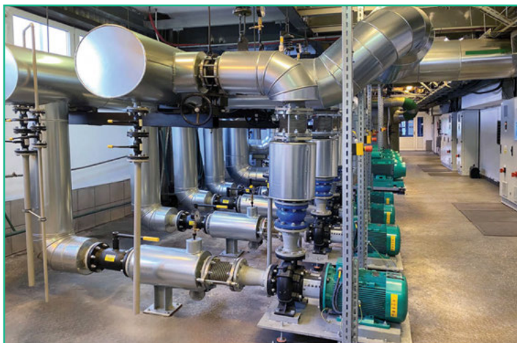
Fot. 1. Pompy kotłowe Atmos GIGA-B i obiegowe Atmos GIGA-N w ECO Malbork
