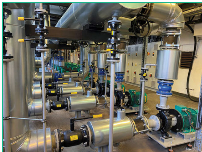
Fot. 3. Pompy kotłowe Atmos GIGA-B i obiegowe Atmos GIGA-N
