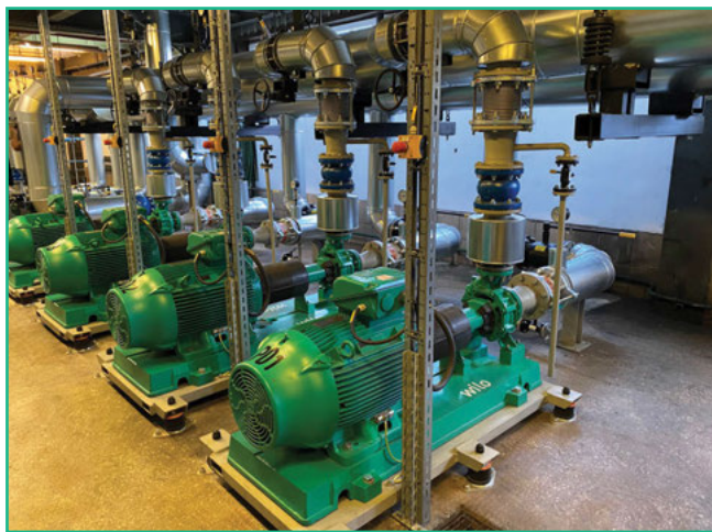
Fot. 2. Pompy obiegowe Atmos GIGA-N
