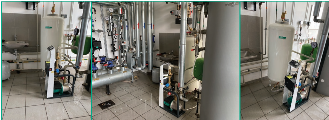
Wilo-Sinum MONO + zbiornik beciśnieniowy 200 litrów w kotłowni Wilo w Lesznowoli
